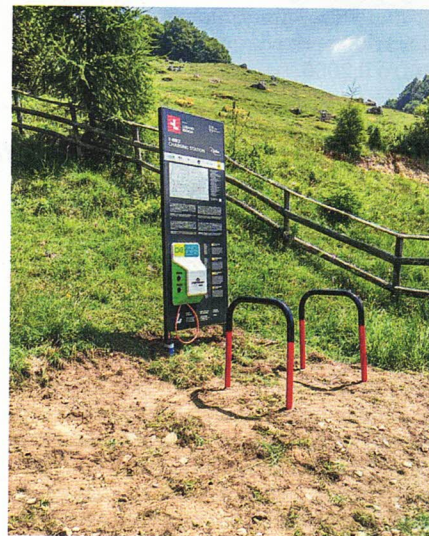
Nella foto: l'impianto di ricarica per mountain bike alla capanna Pairolo.
